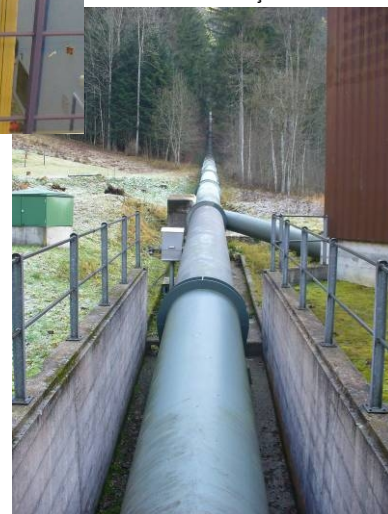
Conduite d'amenée à la centrale de la Rançonnière
